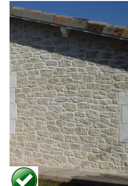
Mur sain : Végétalisation possible
