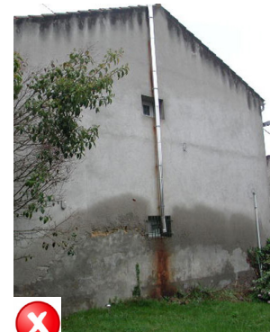
Mur présentant des pathologies : végétalisation à proscrire
