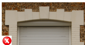
TRAVAUX INADAPTÉS : Coffre de volet roulant intégré derrière le linteau mais visible.
