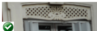
BONNE PRATIQUE : Intégration du coffre de volet roulant en retrait habillé par un lambrequin en bois peint.
