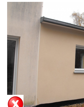
Mauvaise pratique : Raccord bord à bord et utilisation d'un couvre joint en PVC entre existant et extension
