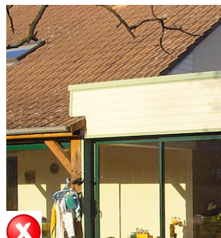
Mauvaise pratique : Raccords maladroits entre toiture et façade
