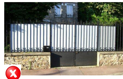
Mauvaise pratique : Couleurs différentes entre la clôture et le festonnage.
