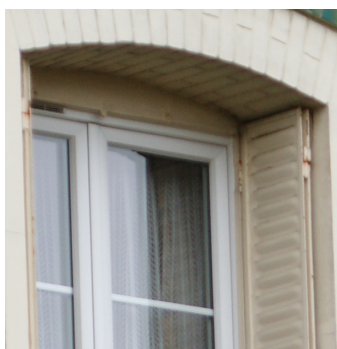
TRAVAUX INADAPTÉS : Pose d'une menuiserie rectangulaire dans une baie en arc surbaissé. Menuiserie plate en PVC blanc avec une baguette inter-vitrage. La menuiserie ne présente plus aucun relief.
