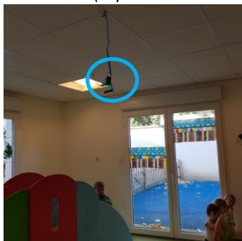
Pièce n°2 (capteur CO2 non visible) :
